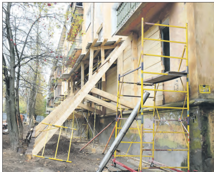
Тула, ул. Смидович, 6. Дом готов к капитальному ремонту, но работы до сих пор не начались.
