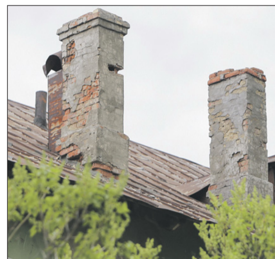
Разрушенные дымоходы многоэтажного дома.
