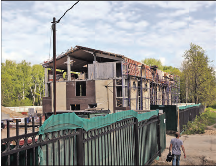
Тула. Полным ходом идёт строительство теннисного центра. Он находится на ул. Кутузова, на участке, прилегающем к Пролетарскому парку.
