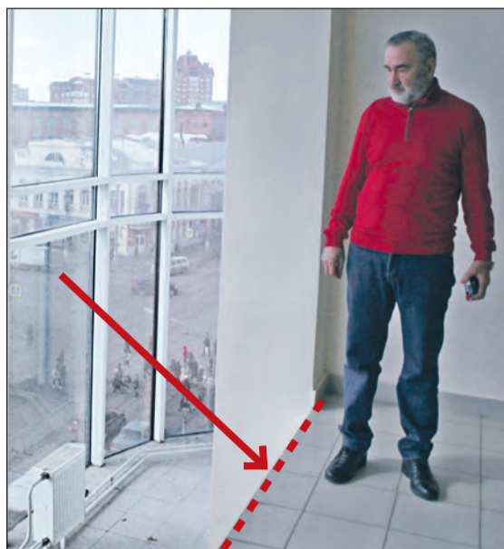
ТРЦ «Гостиный двор». На лестничной площадке 4-го этажа нет ограждения. На фото Рафик Папьян.
