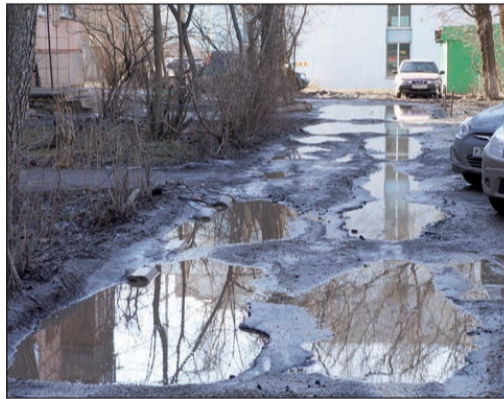
Тула, ул. Metallургов, 79. Причина грязи – нет покрытия, нет бордюров, нет дренажа.
