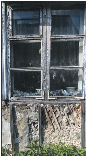
Стены дома наглядно демонстрируют его аварийность.
